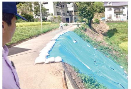
中部地区の方から「大雨で崩れてしまって心配」という相談を受け現場へ。
